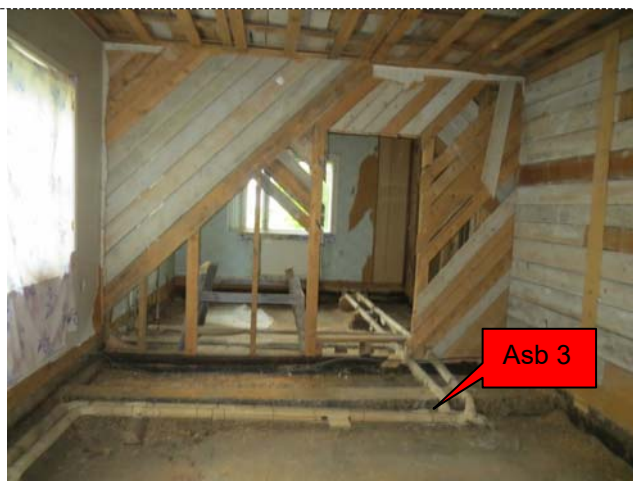
Näyte 3, Olohuone PUTKIERISTEISSÄ ASBESTIA
