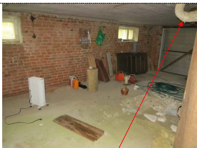
Myös kellarin osalla on putkistot osittain eristetty, putkieristeissä asbestia.
